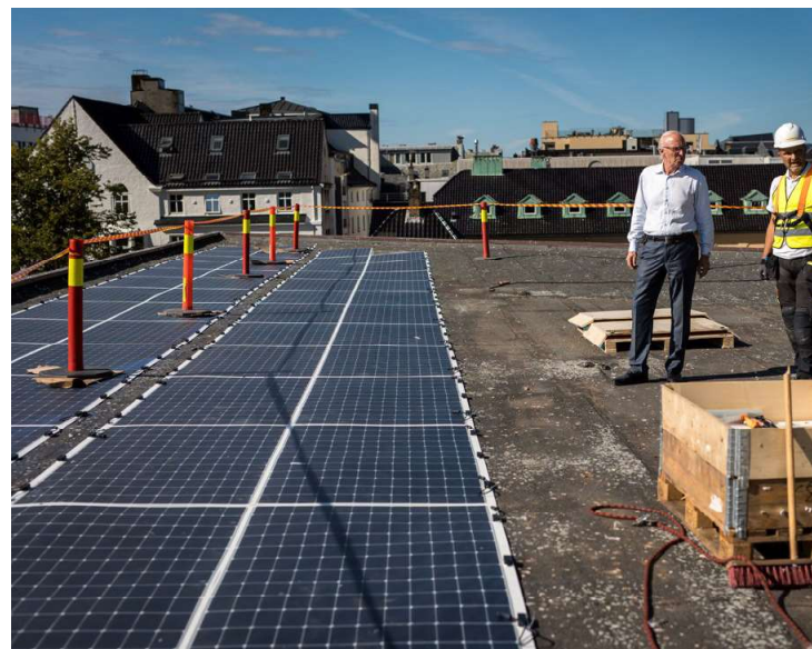
Grighallen er blant byggene som fikk installert solcellepaneler i 2022.
