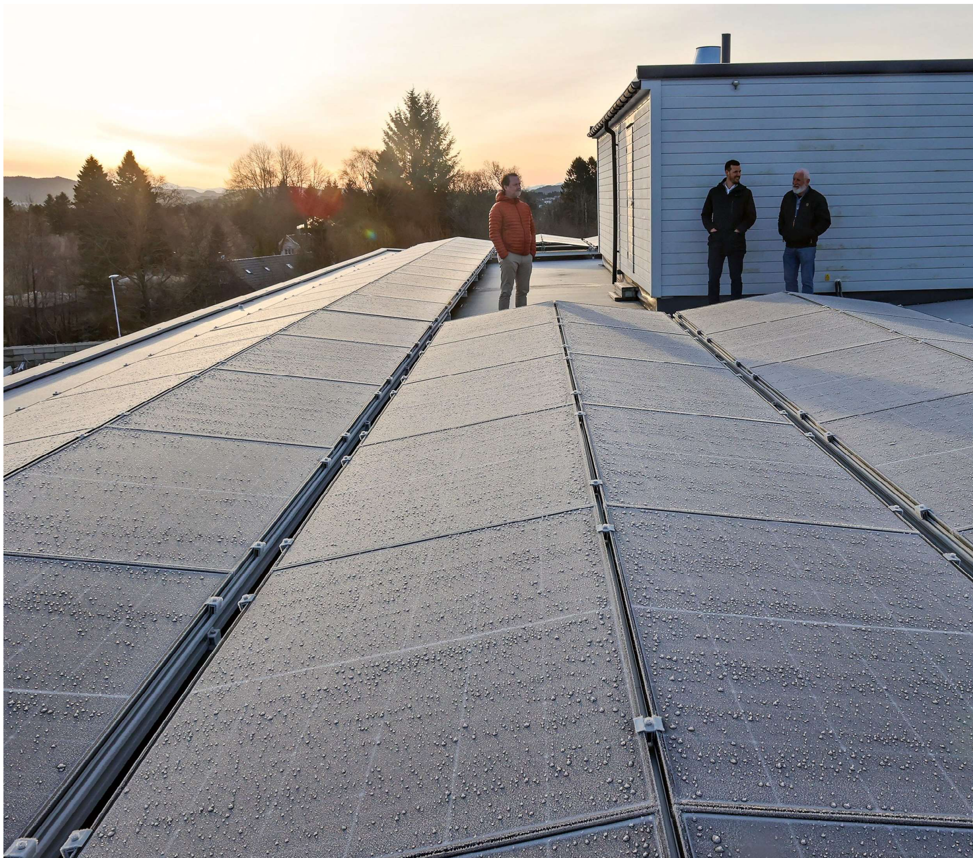
1800 kvadratmeter tak hos Løvaas-selskapene i Blomsterdalen er dekket av solcellepaneler.
